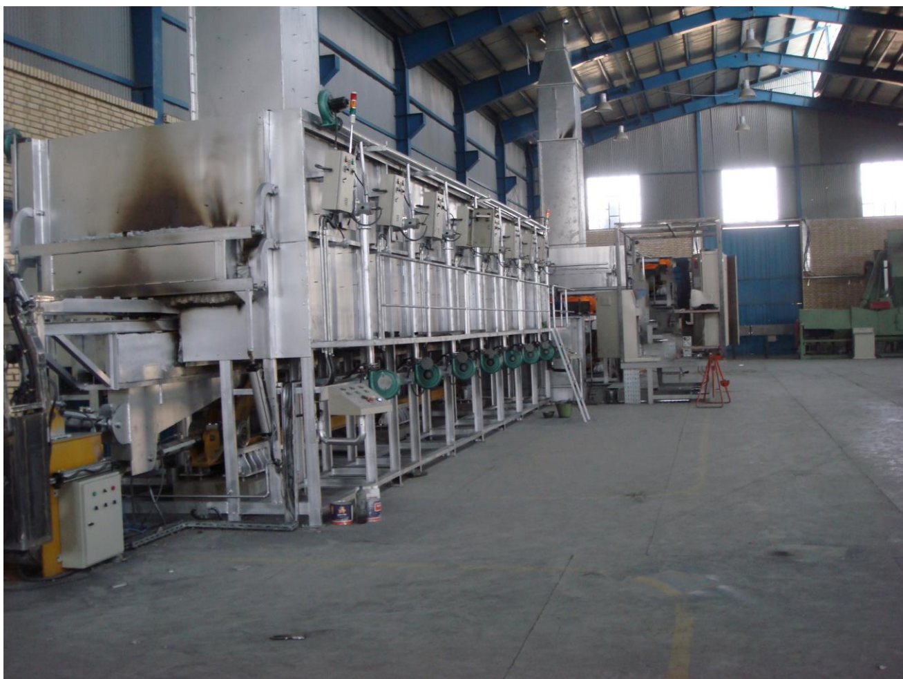
کوره عملیات حرارتی متحرک نیمه اتوماتیک
